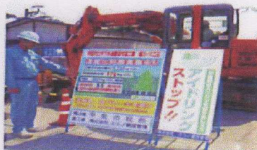
CO2の削減目標や現在の削減量を記した立て看板と、エコモードで稼働している掘削機＝甲斐市西八幡
